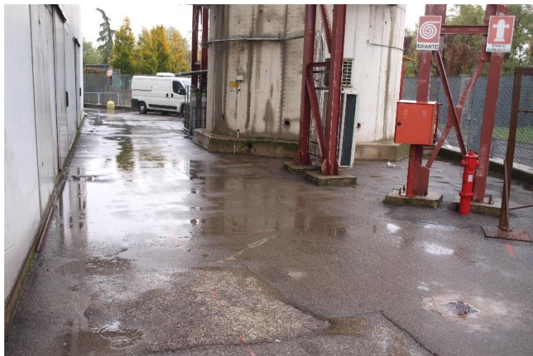
Foto 4: unità 2. Dettaglio dell'area del camino. La struttura sarà oggetto di demolizione e ricostruzione. Vista da Ovest.
