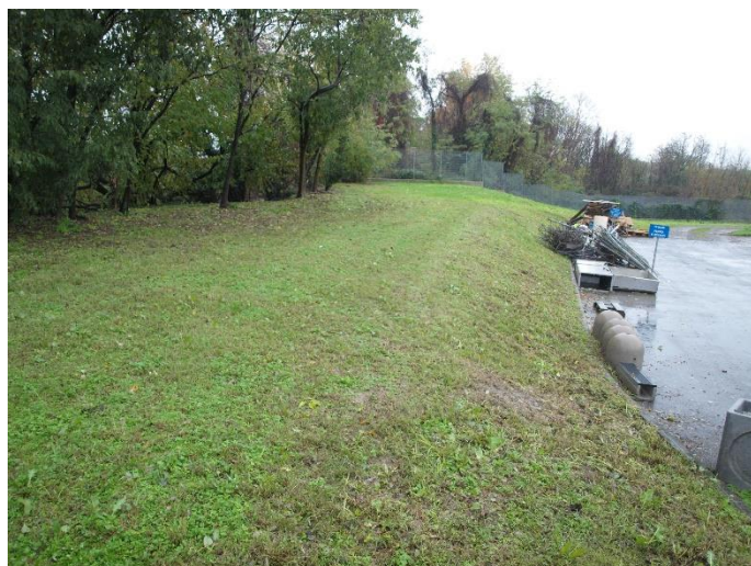
Foto 9: unità 5. Terrapieno dell'argine oggetto dei nuovi interventi di innalzamento. Vista da Nord.
